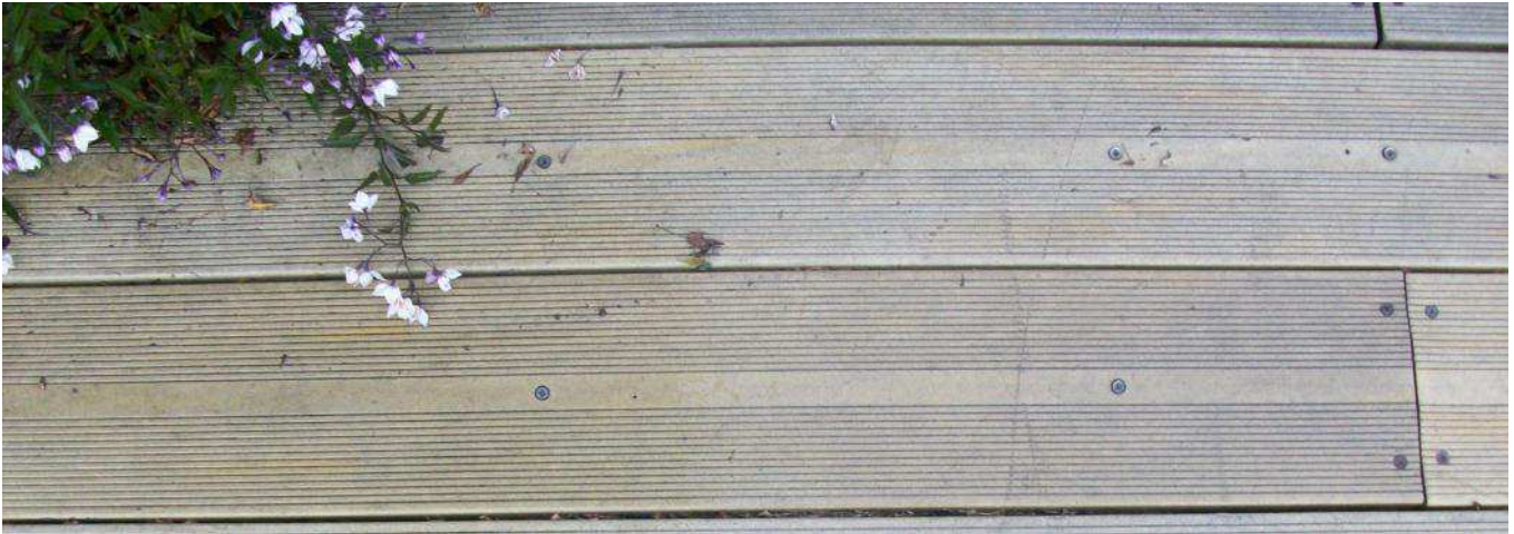
PISO CON SUCIEDAD Y RAYONES
